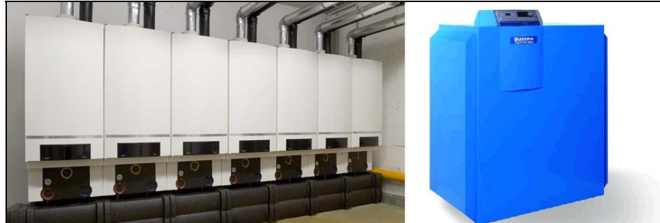
Figuur 12 HR-ketels (links) in cascade en een grote HR-ketel (rechts)
