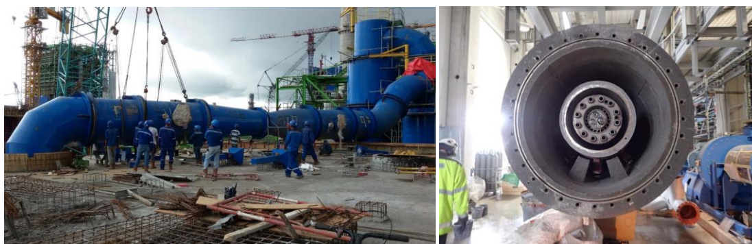
Figuur 3 – Leiding (110 MW) en brander (87 MW) voor heet laagcalorisch stookgas
