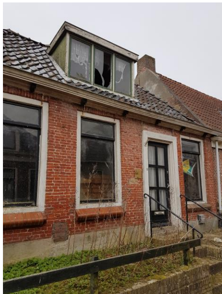
Figuur 3 - Slecht onderhouden pand in Holwerd
