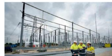
HS-MS station (van 110-150 naar 3-23 kV)
