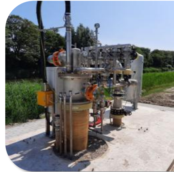
De bovengrondse installatie van een van de HTO-putten en de monitoringsput
